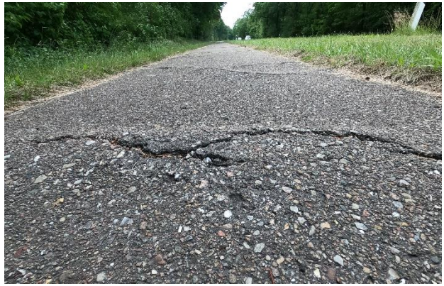
Abbildung 35: Schlechter Zustand des Radwegs
