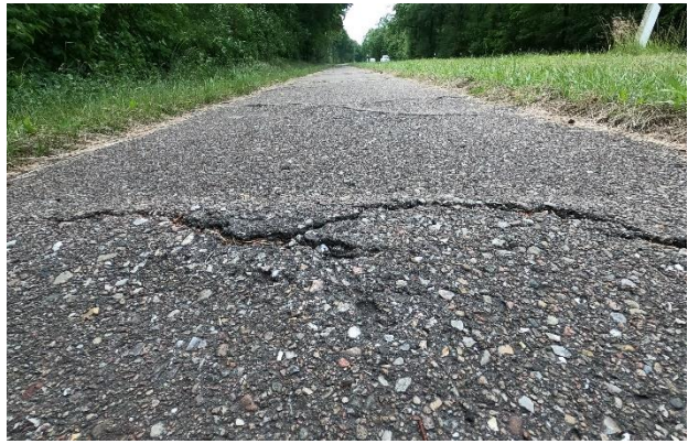
Abbildung 35: Schlechter Zustand des Radwegs
