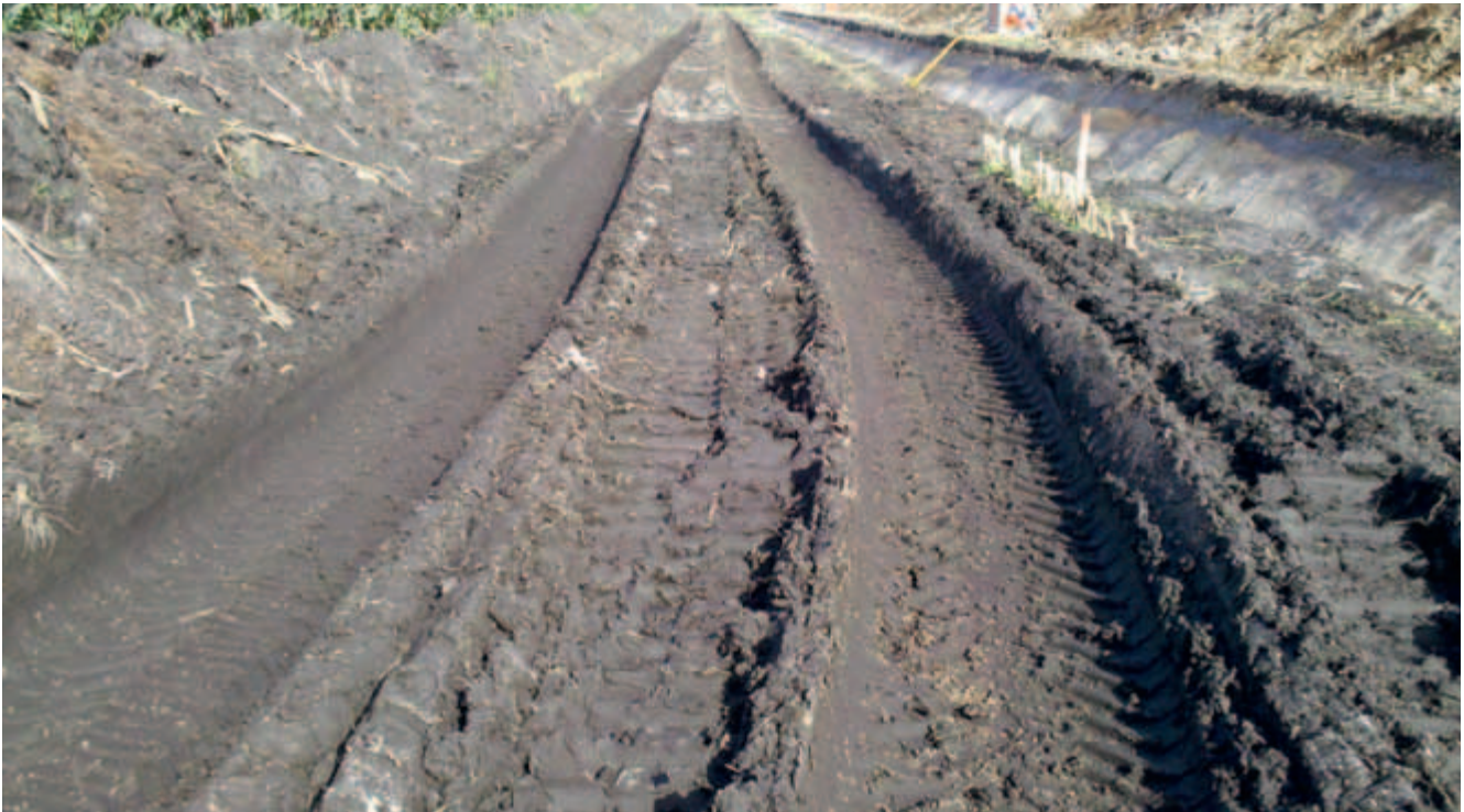
Abbildung 1: Tiefe Fahrspuren entlang eines Leitungsgrabens
